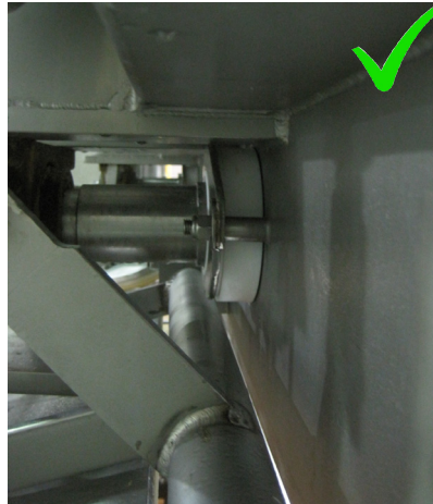
El eje se separa de la pared de la mezcladora para evitar el ingreso del aceite o grasa.
